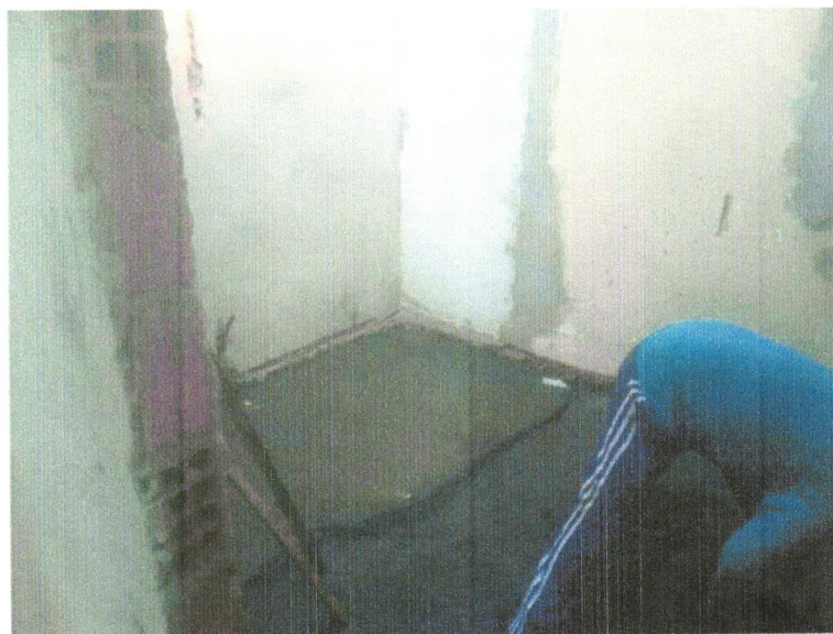
Foto 17- contrapiso em argamassa traço 1:4 (cimento e areia), preparo mecânico com betoneira 400l, aplicado em áreas secas sobre laje, não aderido, acabamento não reforçado, espessura 5cm. Af_07/2021
