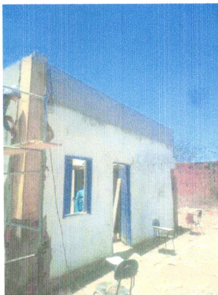
FOTO 09 – COMPOSIÇÃO REPRESENTATIVA) EXECUÇÃO DE ESTRUTURAS DE CONCRETO ARMADO, PARA EDIFICAÇÃO HABITACIONAL UNIFAMILIAR TÉRREA (CASA EM EMPREENDIMENTOS) FCK=25MPA. AF_01_01/2017
