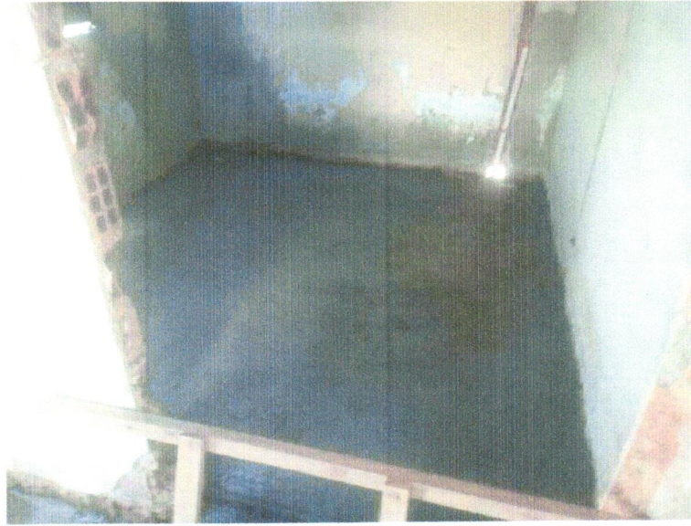
Foto 15 - contrapiso em argamassa traço 1:4 (cimento e areia), preparo mecânico com betoneira 400l, aplicado em áreas secas sobre laje, não aderido, acabamento não reforçado, espessura 5cm. Af_07/2021
